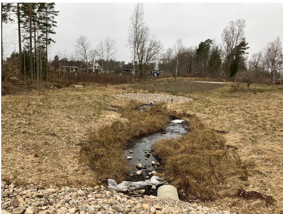
Figur 26. Befintlig dagvattenanläggning vid Braxvägen (ID C i Bilaga 1). Taget från Braxvägen i västlig riktning. Trumma som anas i slutet leder ej till ledningsnät utan leder
